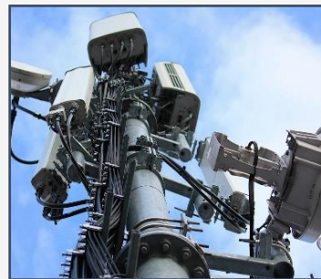
Componenti di accesso radio
